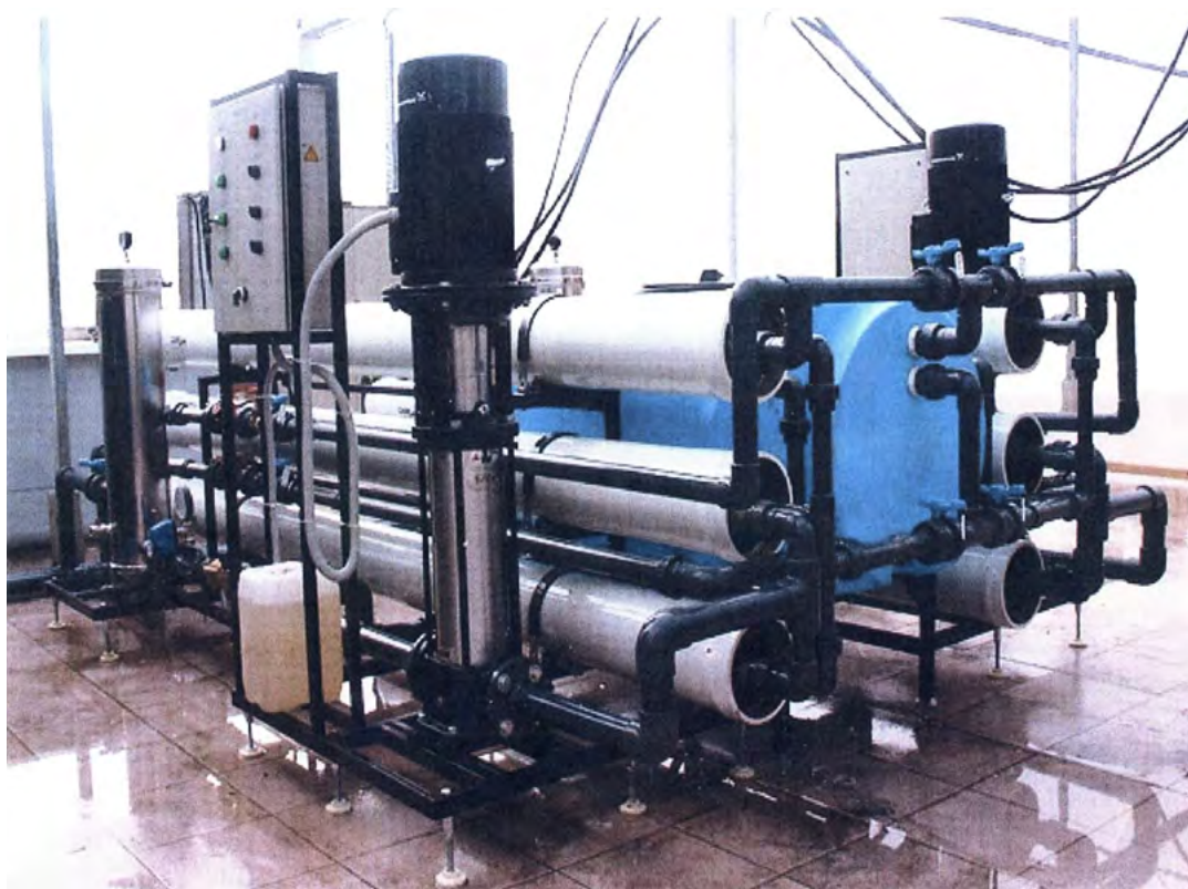
Рис. Установка обратного осмоса
